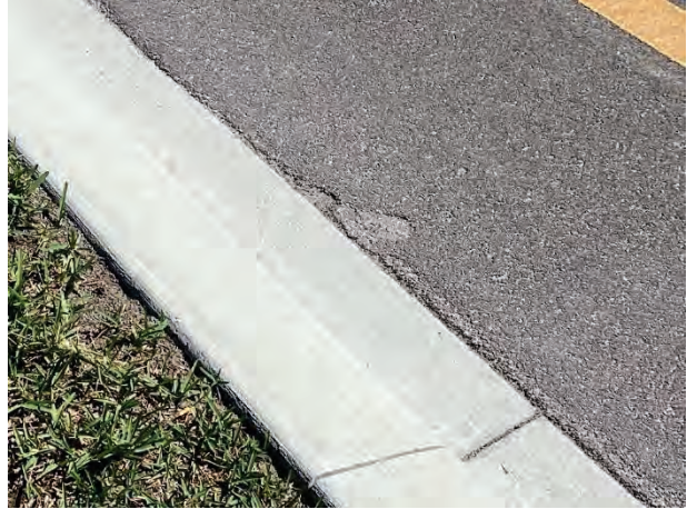
Anthem Pkwy. – deterioration evident
